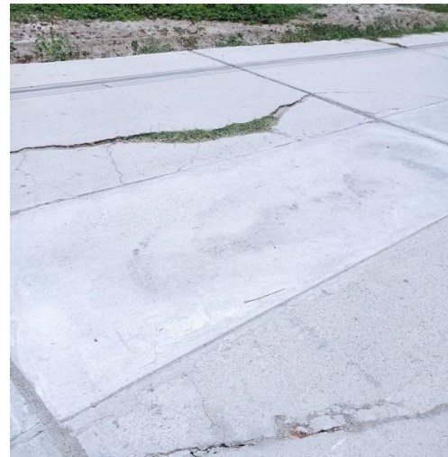
Figura. 1.2 Grietas en el pavimento rígido
