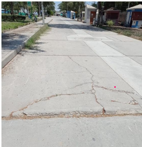
Figura. 1.1 Daño de pavimento rígido
