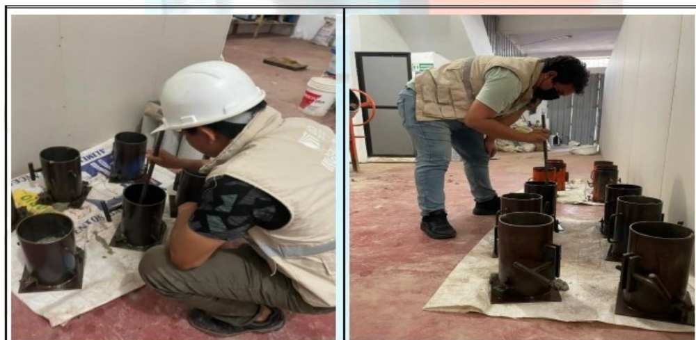
Fotos nº 13-14: En las imágenes podemos observar al personal realizando el moldeo de los testigos de concreto.
