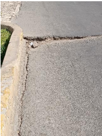
Figura 1. Presencia de deformaciones superficiales en el pavimento.
