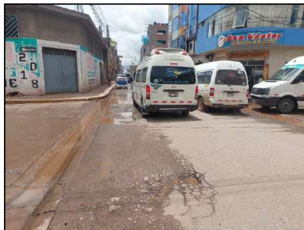
Figura 1. Calles de Juliaca deterioradas
