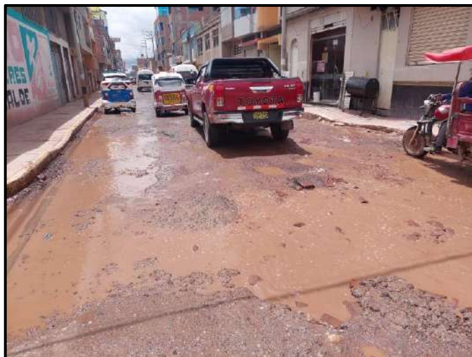
Figura 2. Vías deterioradas en Juliaca
