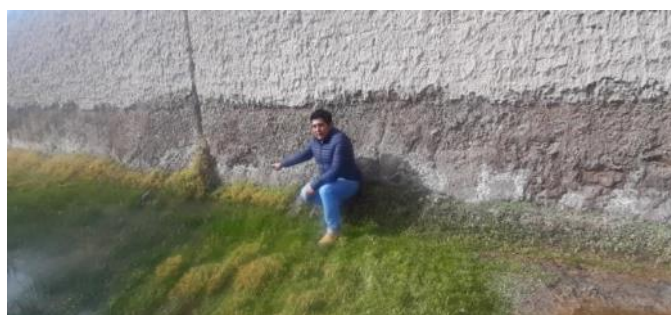
Figura 3: Ejemplo de Eflorescencia
