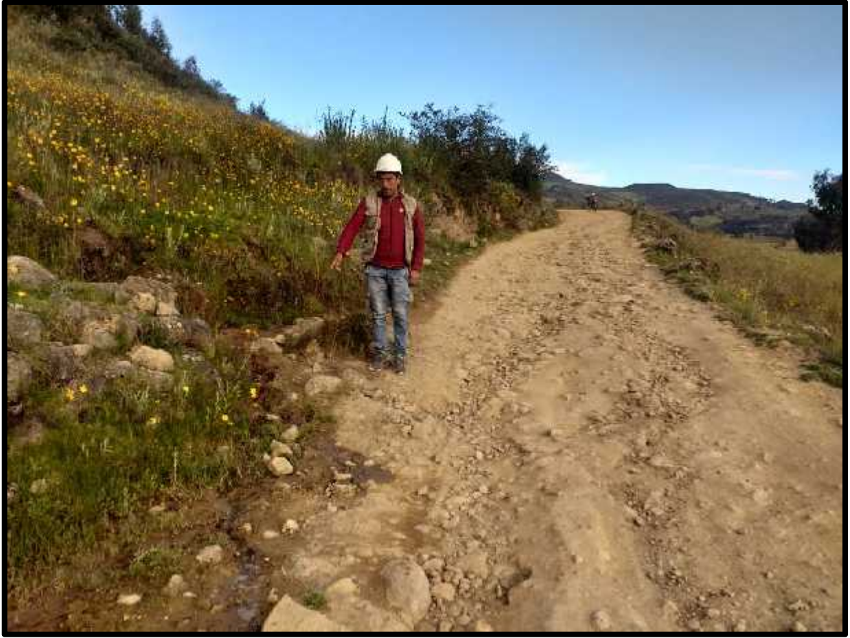
Falta cunetas para evacuar el agua y así no malograr la vía de la carretera.
