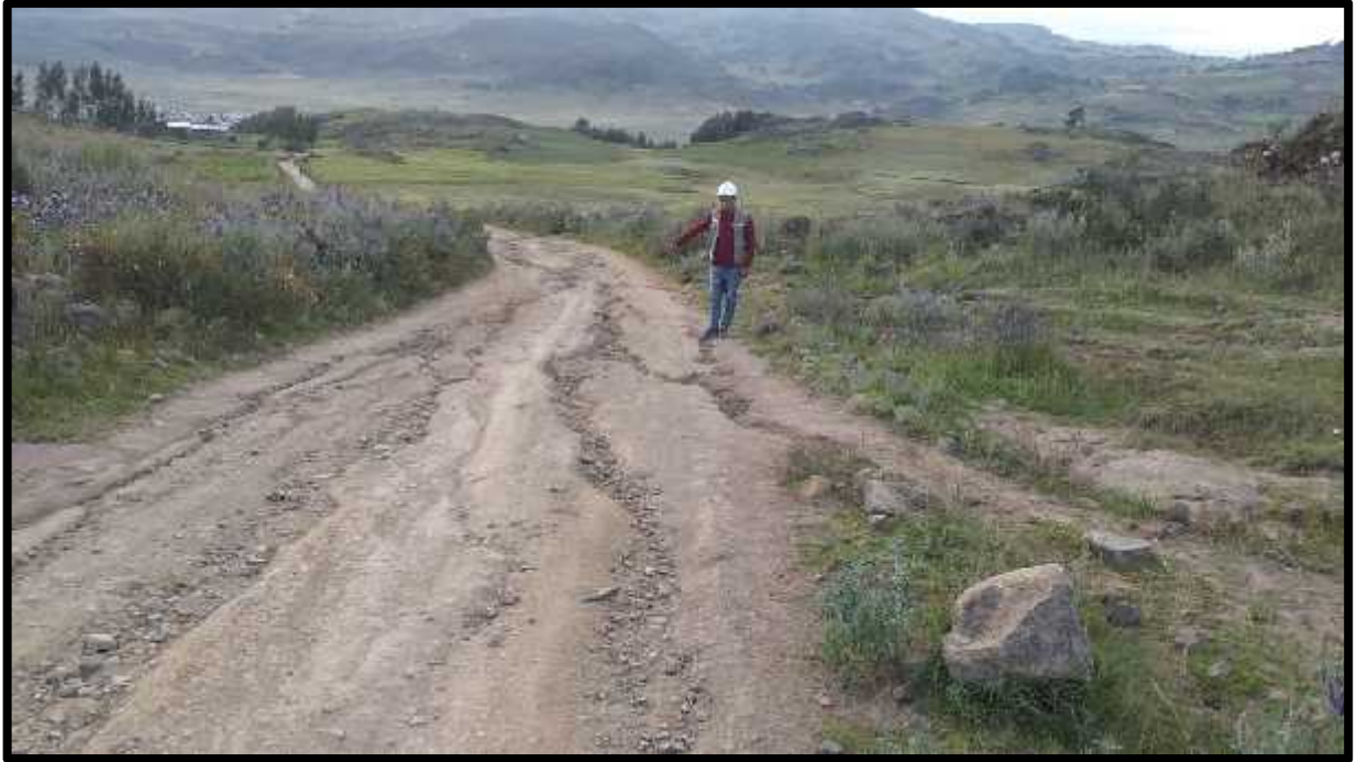
Carretera en mal estado, presenta zanjas debido a las intensas lluvias y al no contar con sus respectivas cunetas.
