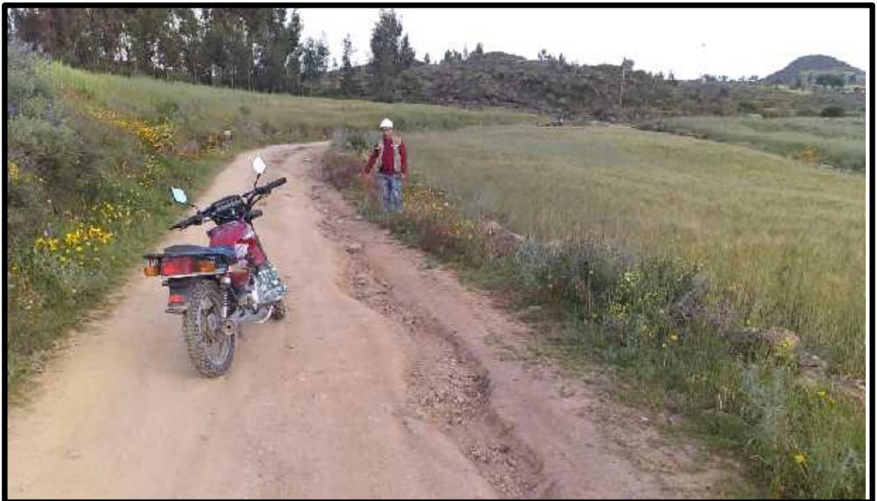
Carretera en mal estado, presenta zanjas debido a las intensas lluvias y al no contar con sus respectivas cunetas, a los alrededores se puede apreciar las siembras de trigo, cebada; al ser una zona dedicada exclusivamente a la Agricultura y ganadería.
