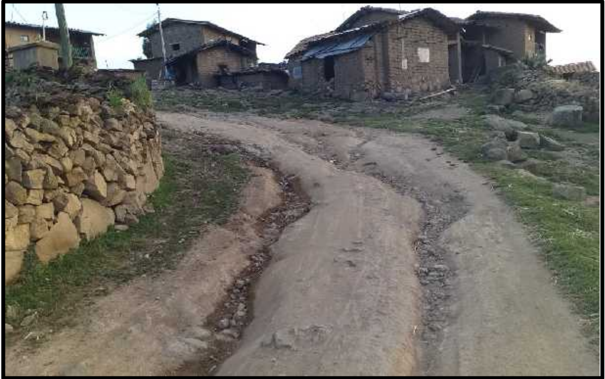
Curva en mal estado, presenta zanjas debido a las intensas lluvias y al no contar con sus respectivas cunetas al mismo tiempo se puede apreciar pendientes que superan el 10%.
