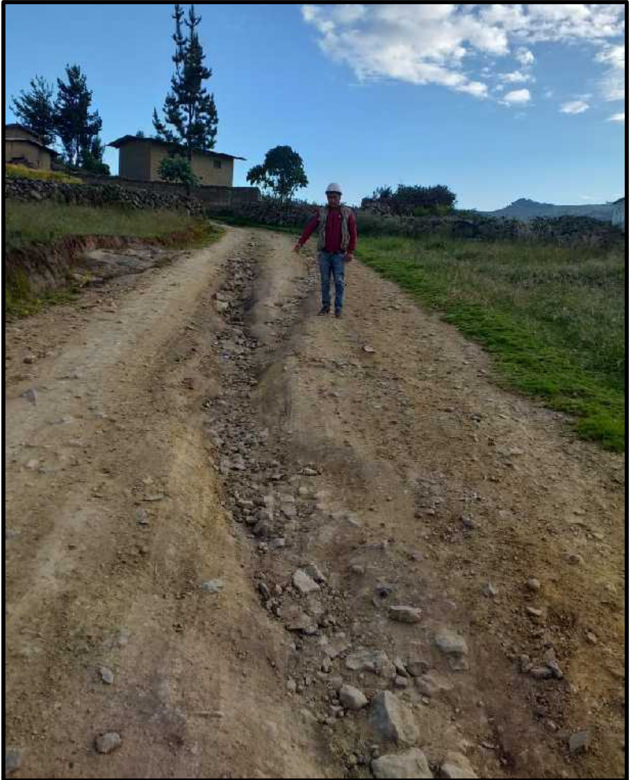
Carretera sector Los pinos presenta zanjas, debido a las intensas lluvias y al no contar con sus respectivas cunetas.
