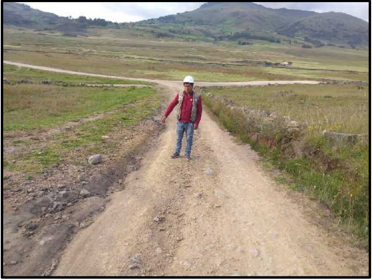
Inicio del tramo de la carretera, Los pinos. La carretera presenta zanjas, debido a las intensas lluvias y al no contar con sus respectivas cunetas.
