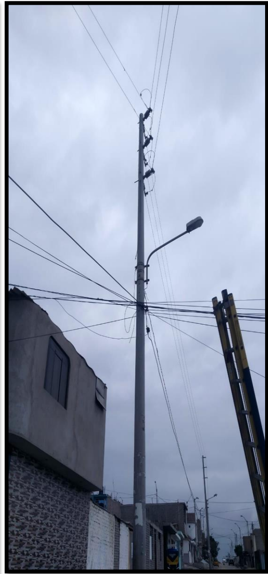
Figura 6: Estructura Nro. E2042119 origen de la línea caída por efecto Galvánico en la Fase R.
