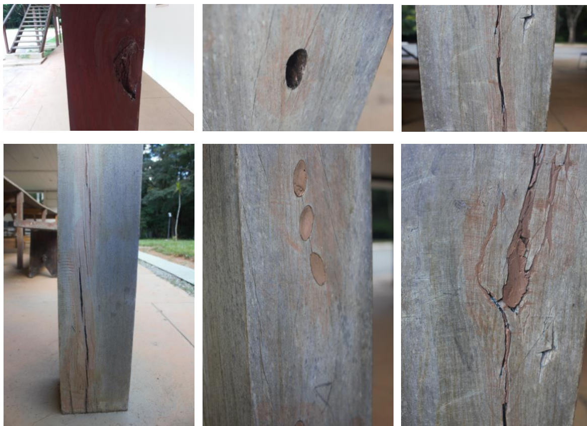
Figura 9. Esteios do Catetinho mostrando perda da camada de pintura, perda de seção por agentes biológicos, preenchimento inadequado das lacunas e fissuração. Fotos: M. M. Mennucci, 2017.
