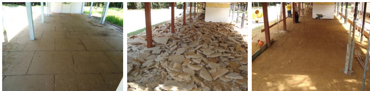
Figura 11. Radier do Catetinho, (a) anterior à reforma; (b) destruição durante a reforma de 2012; (c) radier removido, mostrando aterro original sobre as fundações do Catetinho. Fotos: Marsou Engenharia, dezembro de 2011, segunda quinzena de fevereiro e março de 2012. Fonte: Supac, arquivo digital.
