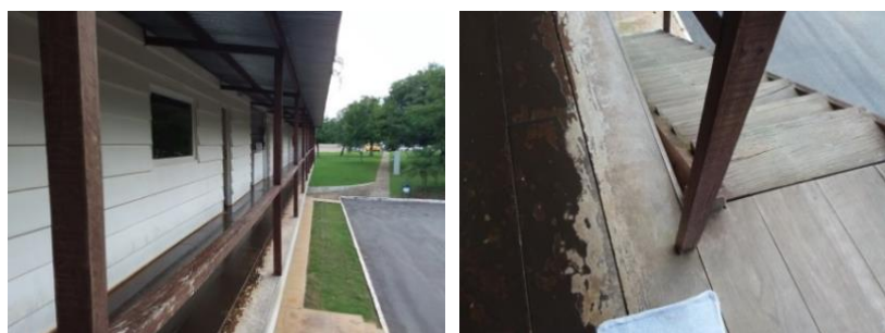
Figura 12. Degradação da pintura realizada em 2012: (a) Piso superior, (b) escada. Fotos: M. M. Mennucci, 2017.
