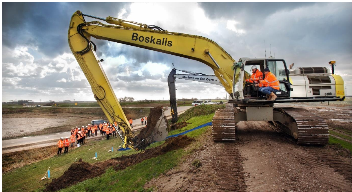
Figuur 11. Werkzaamheden in de Noordwaard (bron: beeldbank.rws.nl, Rijkswaterstaat, Ruimte voor de Rivier / Werry Crone)
