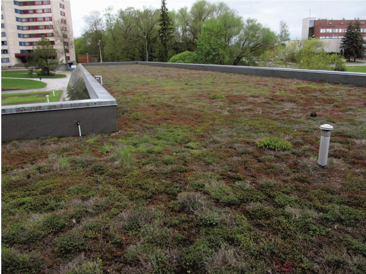
Joonis 7. EMÜ peahoone katusele rajatud tehismulla ( isolatic ) taimkate. Foto: E. Leedu.
