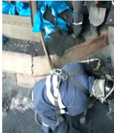
Figura 7- Material com baixa qualidade na aplicação
