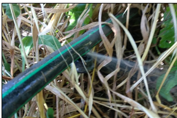
Figura 19- Emissor 1 a 2/3 do comprimento da linha 11, que apresenta uma fuga de água
