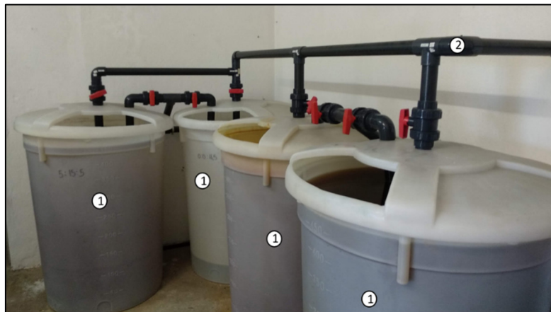
Figura 10- Tanques de armazenamento de fertilizantes
