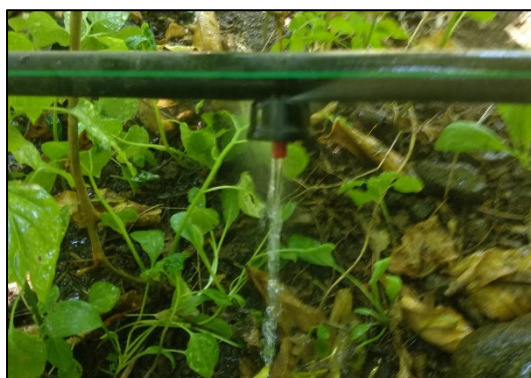
Figura 20- Emissor 2 no final do comprimento da linha 11, que apresenta um caudal em jato e fuga de água
