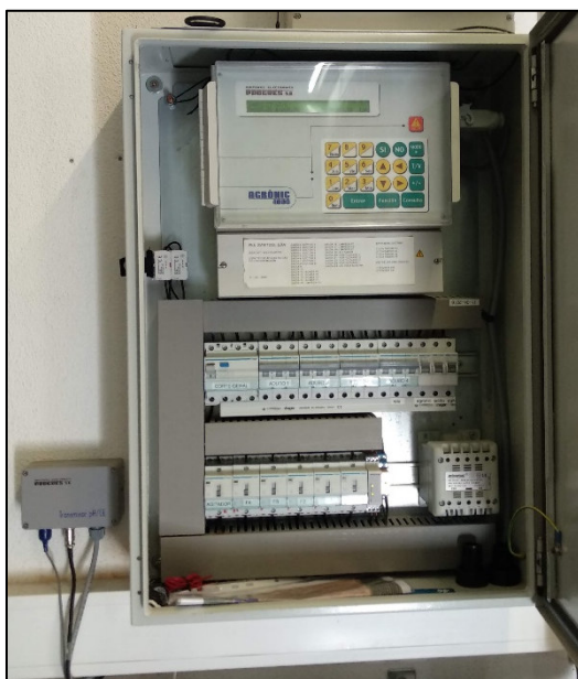
Figura 13- Sistema de automatização Agronic
