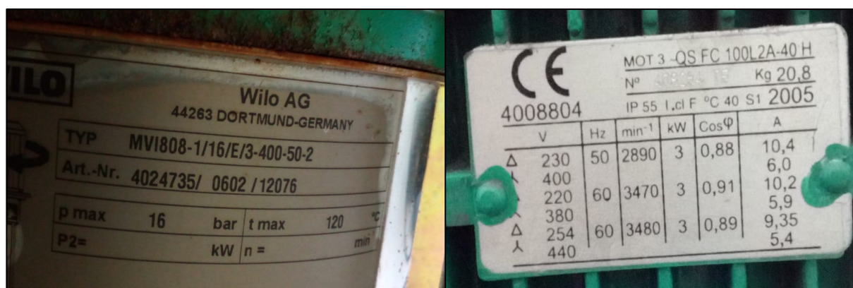
Figura 3- Informações sobre a bomba instalada no reservatório
