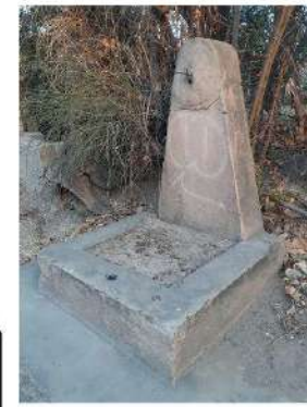
Pueyrredón 1325 SIN FUNCIONAMIENTO
