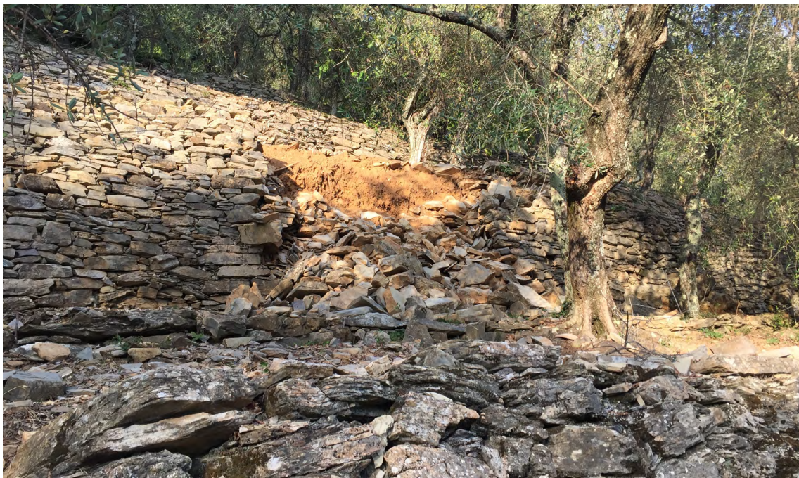
5. Honghe Hani, provincia dello Yunnan, Cina, franamento di muretti a secco e sistema di drenaggio non correttamente mantenuto (foto di Paolo Tarolli)
