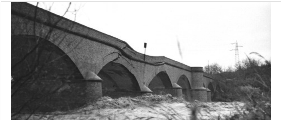
Fig. 3: Crollo ponte sul Trigno durante l'evento di piena del 25 gennaio del 2003.
