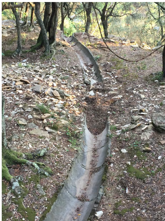
6. Honghe Hani, provincia dello Yunnan, Cina, franamento di muretti a secco e sistema di drenaggio non correttamente mantenuto (foto di Paolo Tarolli)
