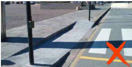
Rampa per carrozzine e passaggio ostruito da pali del semaforo
