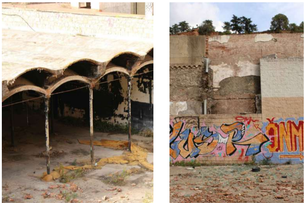
Lesió 1. Lesió voltes de telers a causa d'incendi Lesió 2. Lesió al doble mur de telers fet posteriorment
