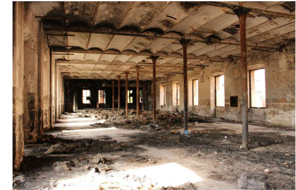
F.11 Interior de Filatures volum principal. Forjat de revoltons ceràmics, pilars de forja. Sobrecàrrega d'ús original= 1,100 kg/m 2 Distància entre murs= 10,70 m. Distància entre pilars= 3,5 m
