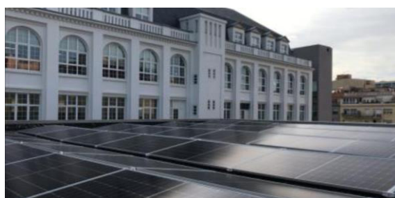
Figure 4-1: Installation of the Comunitat Energètica del Poblenou (source: Energia Barcelona, 2022)
