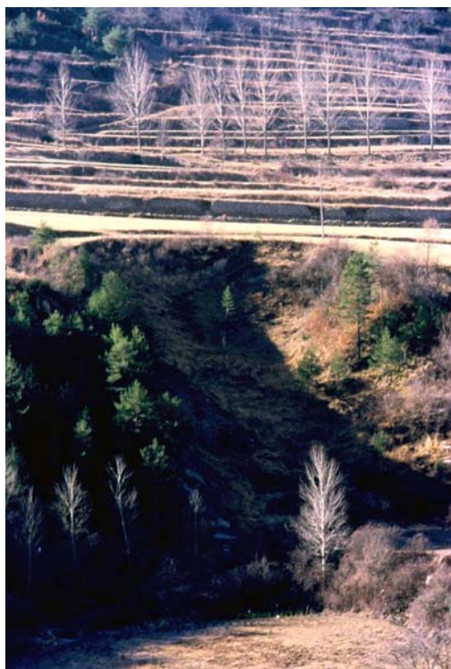
Figura 4.6. Rotura de talud en terraza en la margen del río (foto cedida por Cristina Baeza).
