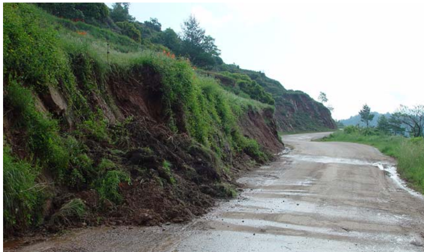
Figura 5.9. Rotura de capa superficial que recubre el sustrato por acción de flujo de agua (autor: Jordi Corominas).
