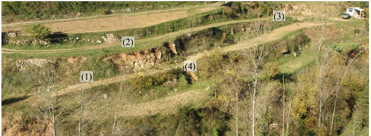
Figura 5.6. Diferentes etapas del mantenimiento de los bordes de las terrazas explotadas actualmente para cultivo. 1) Roturas anteriores sin arreglo, 2) roturas anteriores cuyo muro fue restablecido, 3) ejecución del muro por propietario y 4) roturas recientes.
