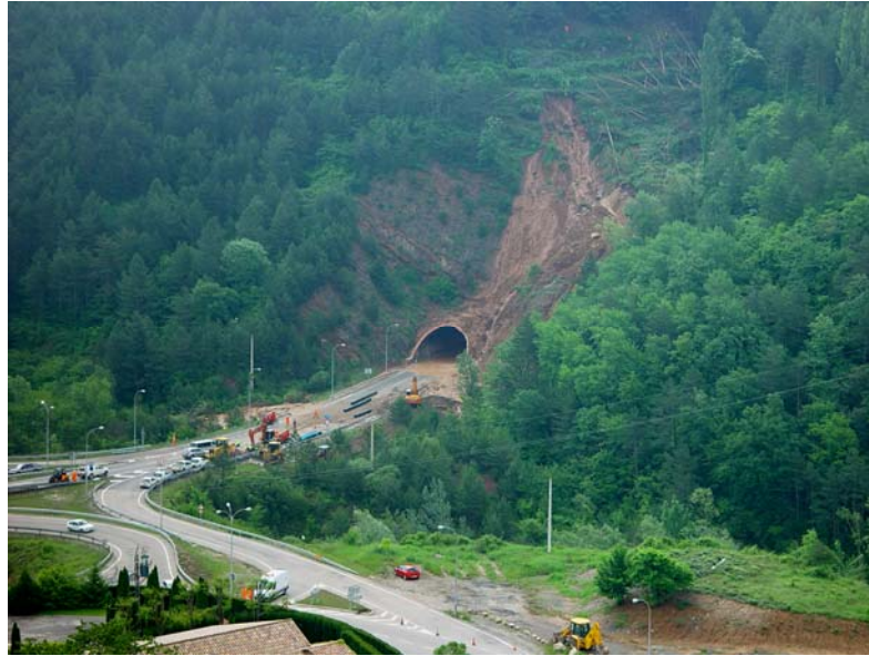
Figura 5.10. Rotura con la formación de una corriente de derrubios en el portal norte del túnel de Berga ocurrida tras las lluvias de 2008 (autor: Jordi Corominas).
