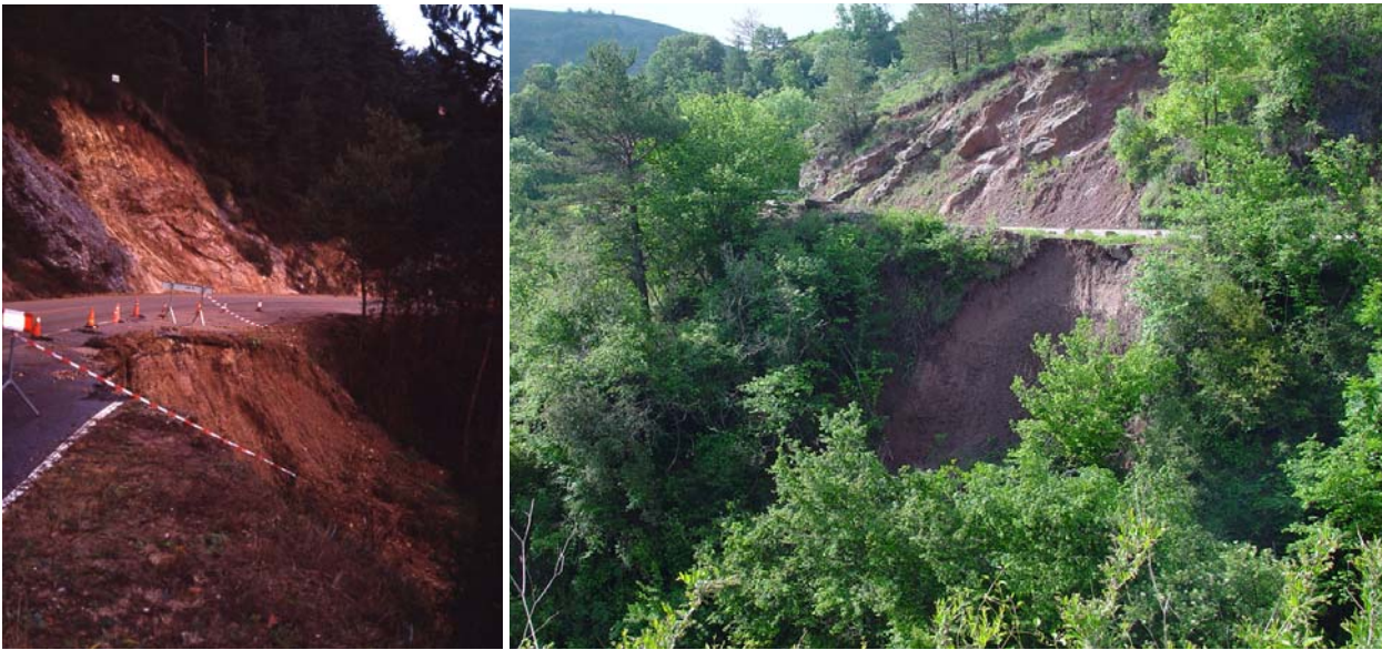
Figura 5.8. Fotos de distintos deslizamientos en taludes viales del año de 1997 (izquierda) y 2008 (derecha) (autor: Jordi Corominas).
