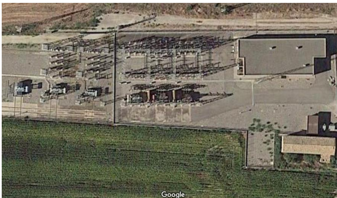
Figura 36. Vista aèria de la subestació elèctrica de Mollerussa
