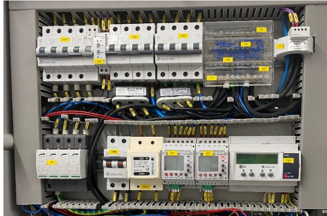
Figura 65 – Quadre AC de la planta fotovoltaica.
