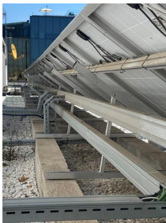
Figura 78 – Safates de la instal·lació.
