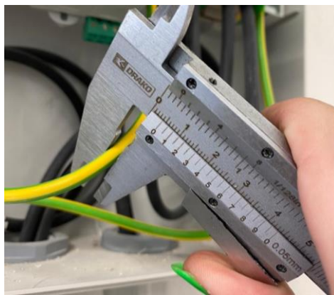
Figura 71 – Mesura amb peu de rei diàmetre de conductor terra DC.
