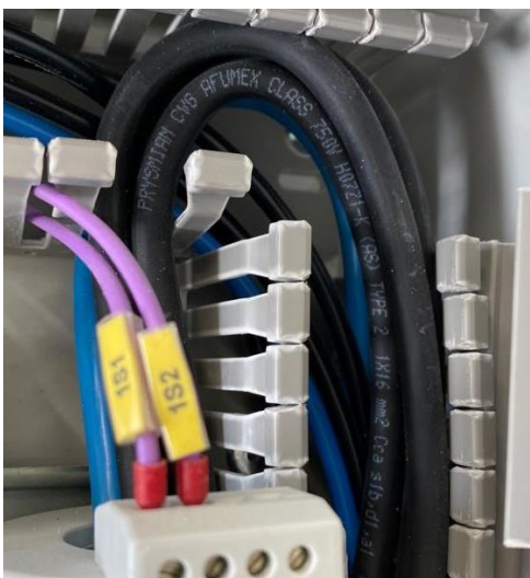
Figura 58 – Conductor AC amb secció indicada.
