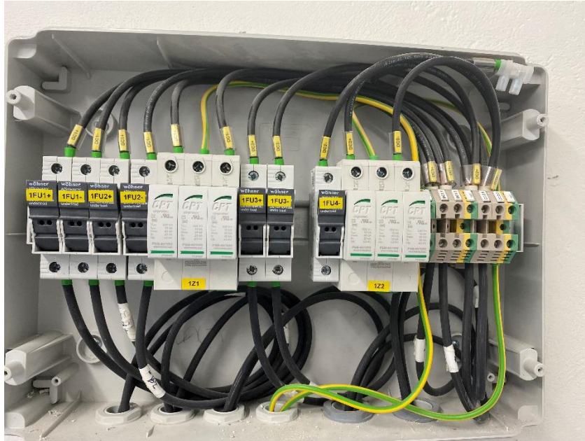
Figura 62 – Quadre DC per Inversor SYMO 15.0-3-M.
