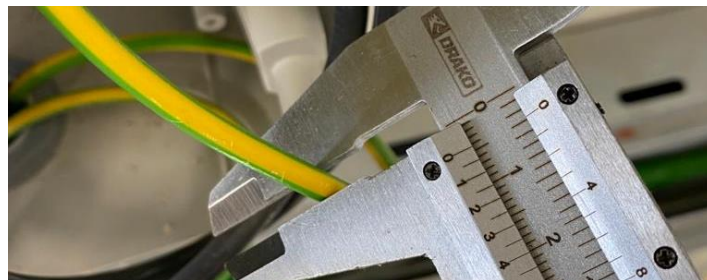
Figura 72 – Mesura amb peu de rei diàmetre de conductor terra DC. Inversor 1.
