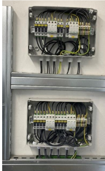
Figura 60 – Quadres DC de la planta fotovoltaica.
