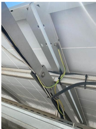
Figura 76 – Únic conductor de terra a la planta.
