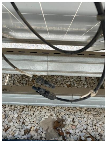
Figura 46 – Cable DC de la instal·lació desconnectat.
