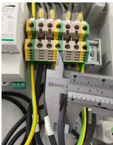
Figura 56 – Mesura amb peu de rei diàmetre de conductor DC.
