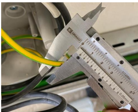
Figura 73 – Mesura amb peu de rei diàmetre de conductor terra DC. Inversor 2.
