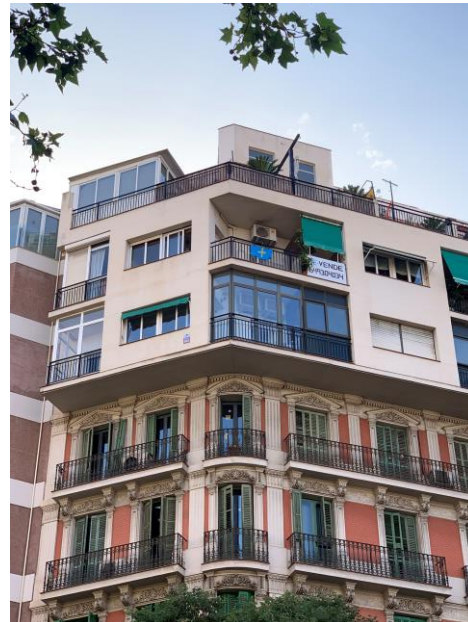
Figura 54. Zoom al trobament entre la façana original i la remunta. Es pot observar que sobresurt molt. Es podria anomenar remunta destructiva.
