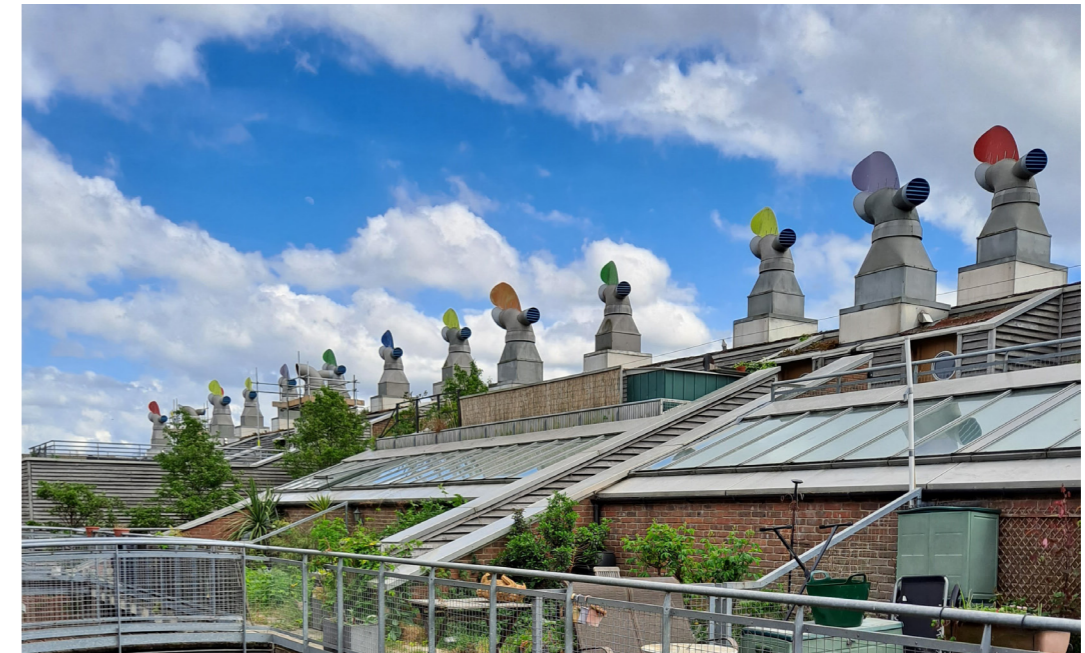
Imatge 15: Xemeneies giratòries per circulació d'aire amb intercanviador de calor
