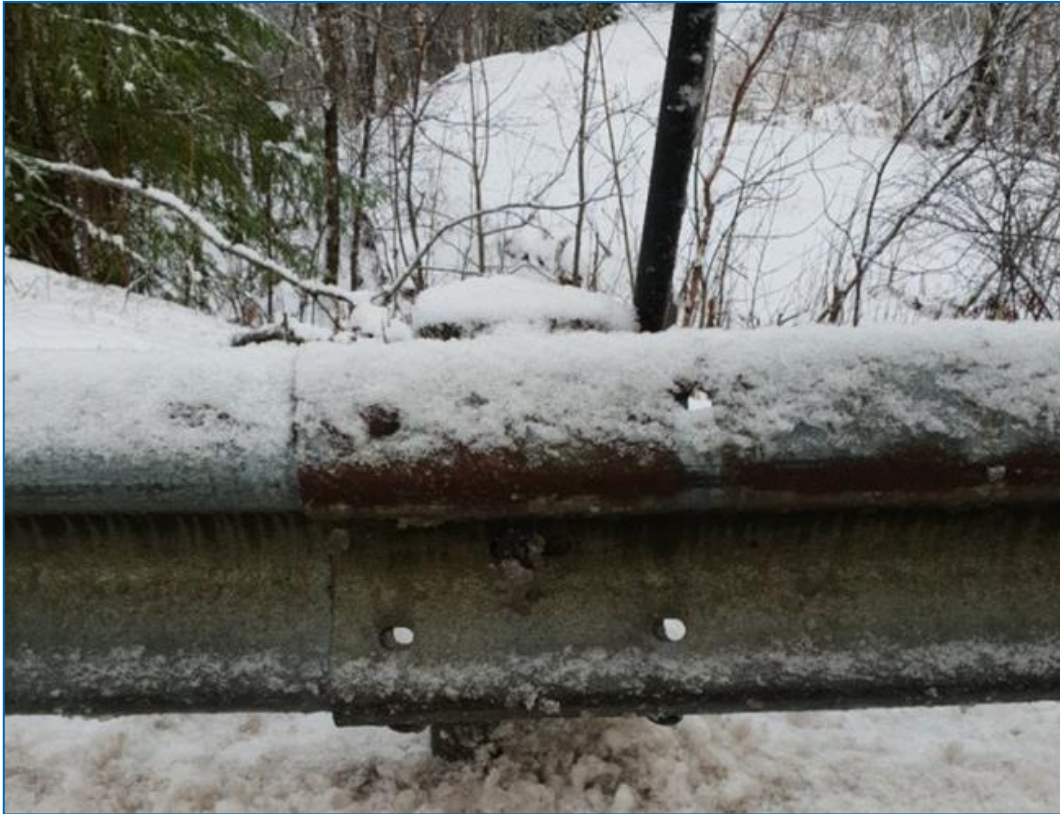
Kuva 4. Vaarallinen vaurio johtuen irronneista kiinnityspulteista. 75
