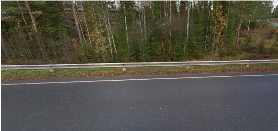
Kuva 12. Liian matala ja ruostunut kaide betonipylväillä (tie 274 tieosa 01, Parkano, tien rakennusvuosi 1970). 93
