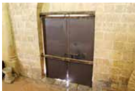
Figura 4. Acceso occidental (vista interior) de la iglesia de la Vera Cruz (Segovia).
