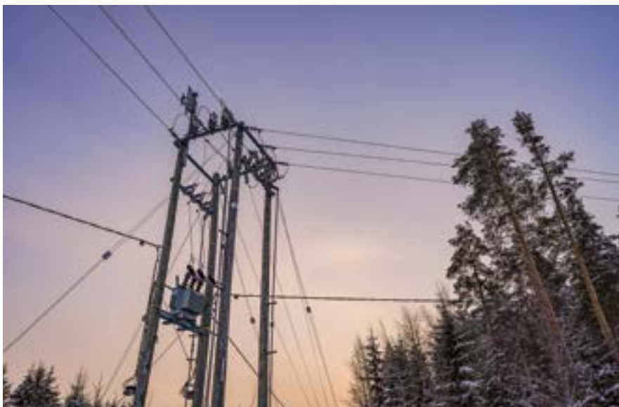
Eroinasema Juvan Kapakassa. Kuva: Suur-Savon Sähkö -konserni.
