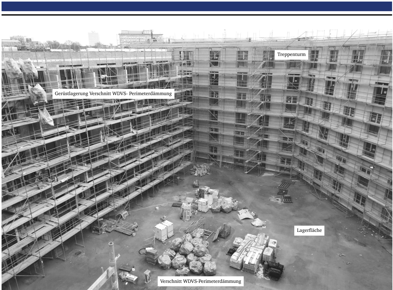
Abbildung 3.6: Innenhof Wohnanlage, Frankfurt am Main, mit Lagerflächen des WDVS (Foto: Jan Schumann, 2016-03-04)
