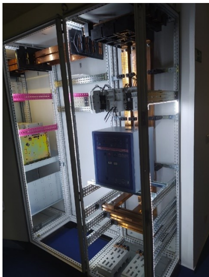
Obrázek 10.2.2 - Ukázka vysokonapěťového rozvaděče
