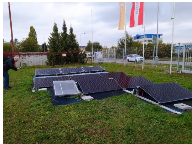
Obrázek 10.1.2 - Ukázka solárních panelů
