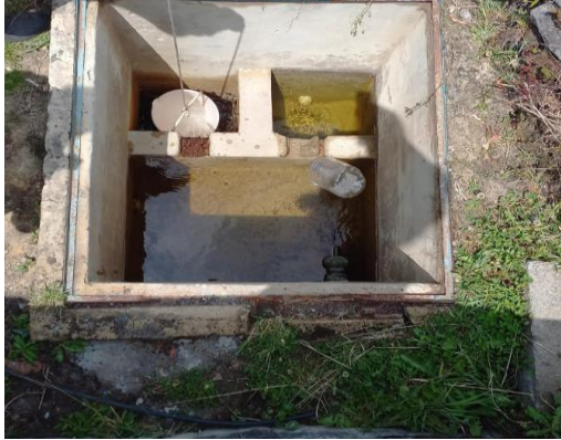
Cámara de control de caudal
