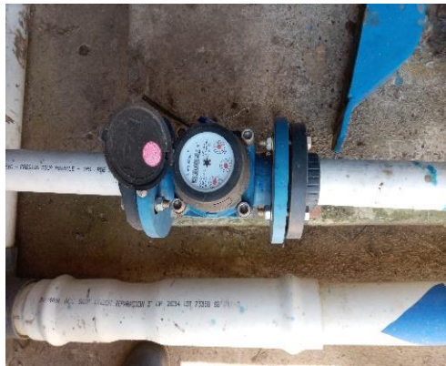
Medidor de agua dañado
