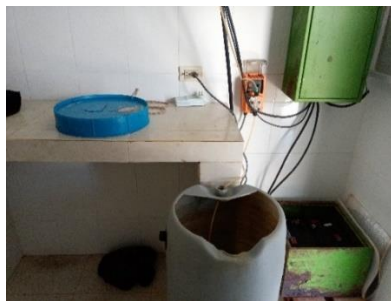
Tanque de Cloro
