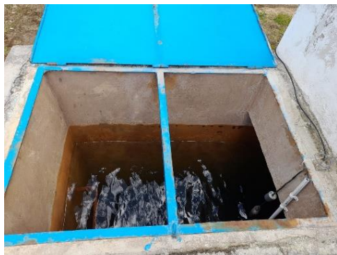
Tanque de Almacenamiento
