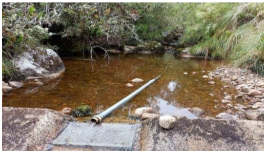
Rejilla de la fuente de abastecimiento
