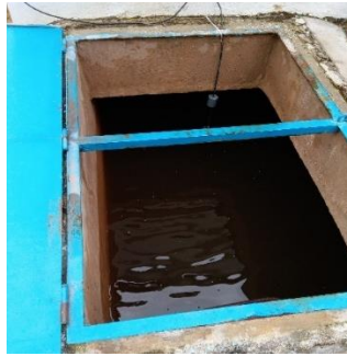
Ilustración 4 Tanque de almacenamiento planta Olarte
