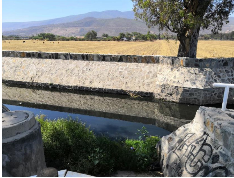
Imagen 14: Vaso Regulador Eucaliptos-Canal de Agua Pluvial- Segunda Fase.
