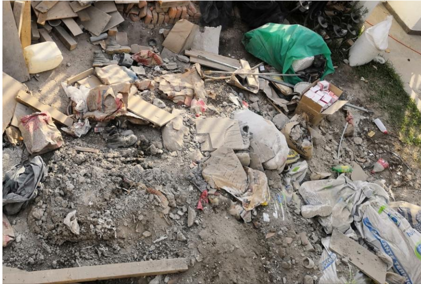
Imagen 7: Residuos de Concreto.
