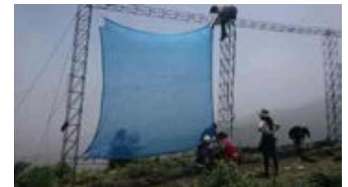
Instalación de Atrapanieblas Lomas de Paraíso, s.f.
