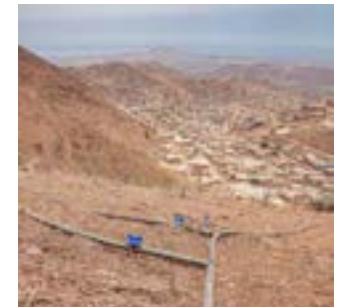
Riego presurizado para lomas Lomas de Paraíso VMT, 2019.
