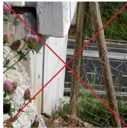
Figura 13.13. Ajuste deficiente entre la valla y la aleta del paso. Foto: F. Navàs.
