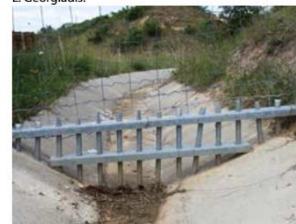
Figura 13.9. Dos alternativas de sistemas destinados a impedir el paso de animales por los puntos de intersección del cerramiento con las cunetas de drenaje perimetral. Fotos: Minuartia.
