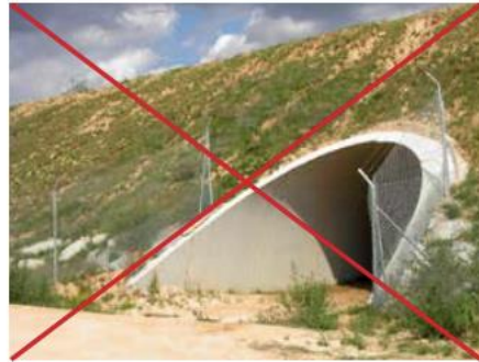
Figura 13.10. La malla debe conducir al paso sin dejar zonas abiertas de acceso al talud. Foto: C. Rosell.
