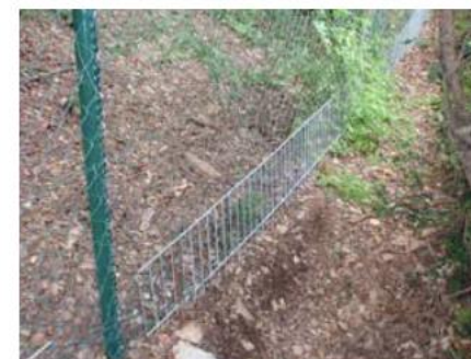
Figura 13.5. Refuerzo para jabalí en un tramo del vallado especialmente conflictivo. Foto: Túneles Barcelona-Cadix.
