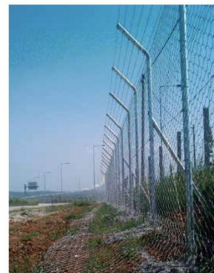
Figura 13.7. Vallado específico para oso, con visera superior y faldón inferior (antes de ser enterrado). Foto: L. Georgiadis.
