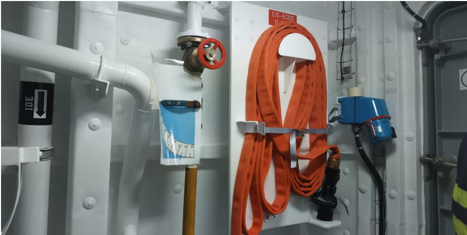
Imagen 5-9: Instalación provisional para pruebas
