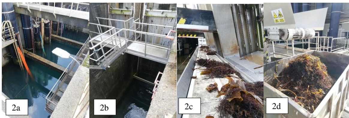
Fig. 2: pozo de bombas (2a), sistema de retirada de algas (2b), cinta transportadora (2c) y contenedores (2d).
