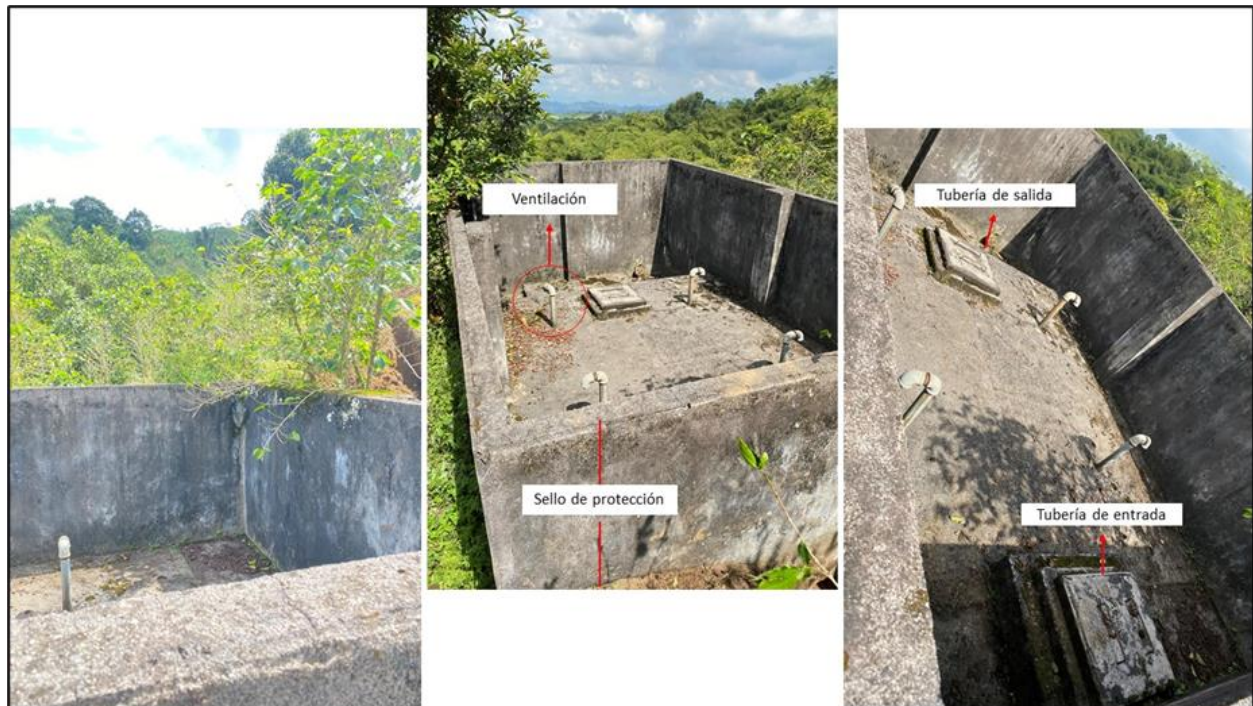
Figura 28. Tanque de almacenamiento de la captación de la quebrada El Colmillo
