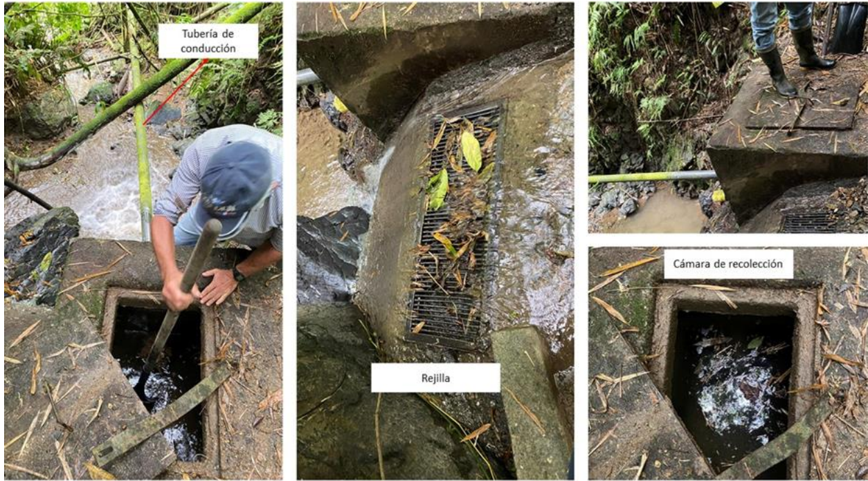
Figura 26. Captación del sistema de abastecimiento de la Vereda San Juanito, Quebrada El Colmillo
