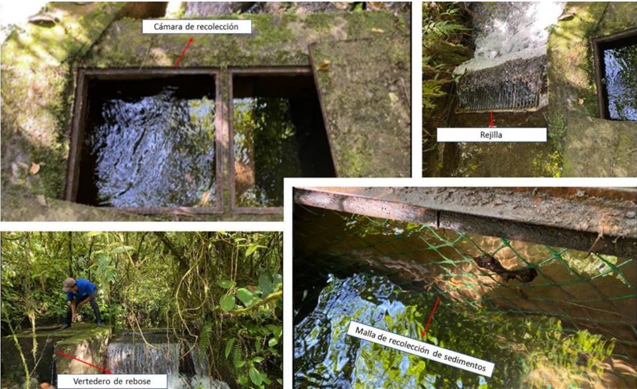
Figura 21. Captación de la Vereda Puente Albán La María, Quebrada San Eustaquio
