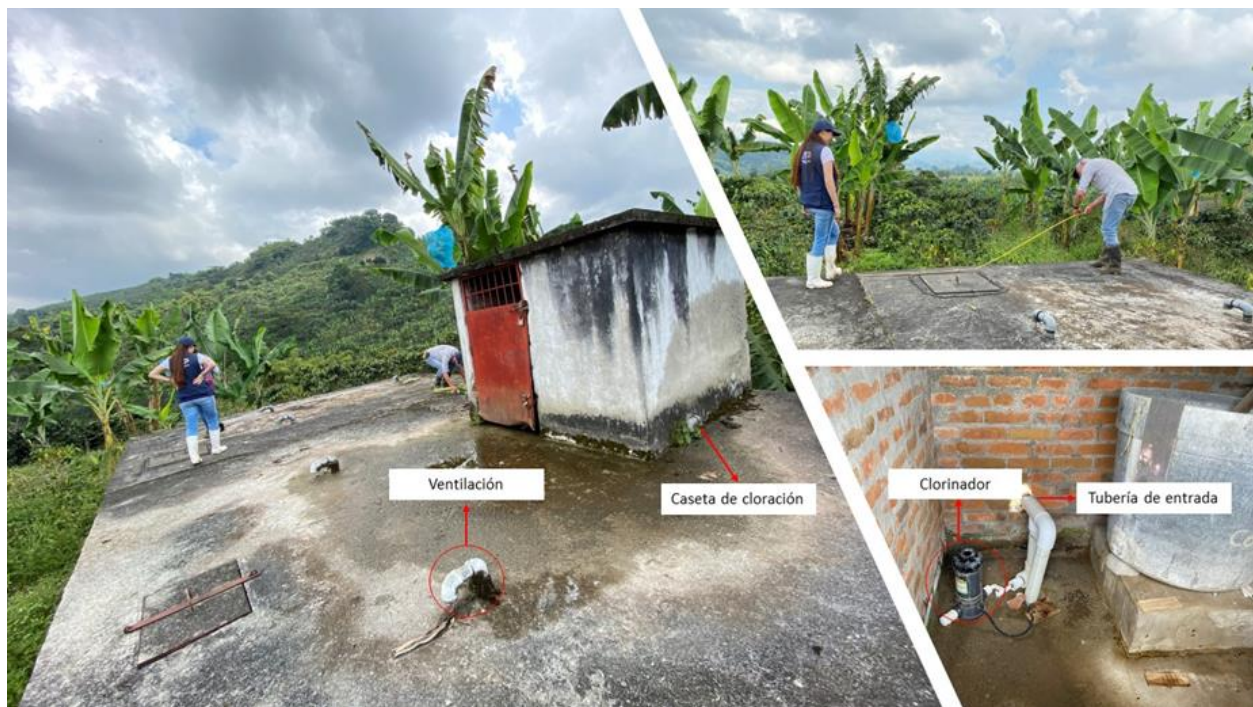
Figura 29. Tanque de almacenamiento de la captación de la quebrada San Miguel
