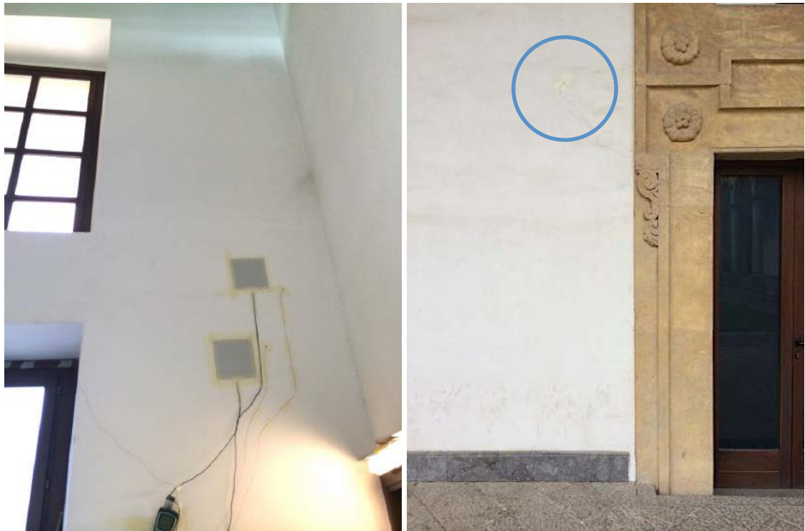
Figure 4.39, 4.40. Punti di misura 1 e 2 (a sinistra) e posizione del sensore esterno di temperatura (a destra).
