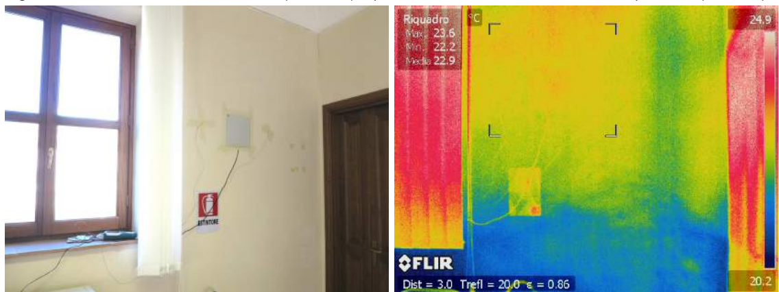
Figure 4.41, 4.42. A sinistra il punto di misura 3, a destra l'immagine termografica, che evidenzia il cavedio.
