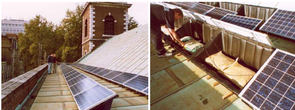
Figure 5.10, 5.11. Pannelli fotovoltaici sulla copertura praticabile della chiesa di Saint James a Londra. Il sistema di sostegno dei pannelli, grazie a un sistema di zavorre, consente di evitare connessioni meccaniche all'orizzontamento.
