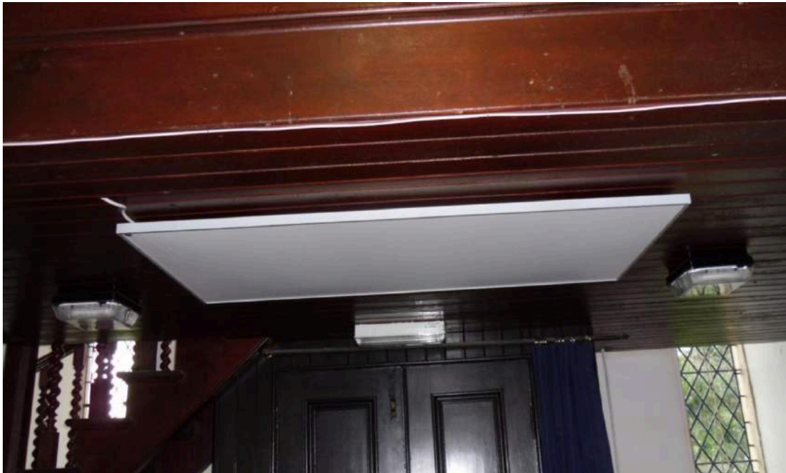
Figura 5.7. Pannello radiante all'intradosso del soppalco del coro all'ingresso della chiesa di Kilmelford, in Scozia. Da Historic Scotland (2015).
