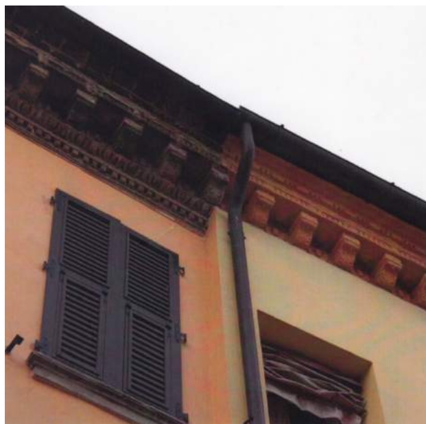
Figura 5.1. L'isolamento delle chiusure verticali è un intervento che incontra notevoli difficoltà d'applicazione, in quanto difficilmente compatibile con la conservazione dei caratteri materici e formali dell'edificio storico. L'esempio di figura, riportato da Ambrogio e Zuppiroli (2013) mostra l'alterazione dei vani di finestra e delle decorazioni del cornicione provocate dall'applicazione di un rivestimento a pannelli su un edificio storico. Da Ambrogio e Zuppiroli (2013).
