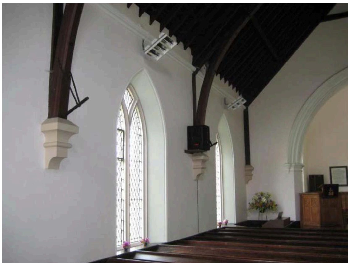
Figura 5.6. Pannelli radianti al livello della cornice nella chiesa di Kilmelford, in Scozia. Da Historic Scotland (2015).
