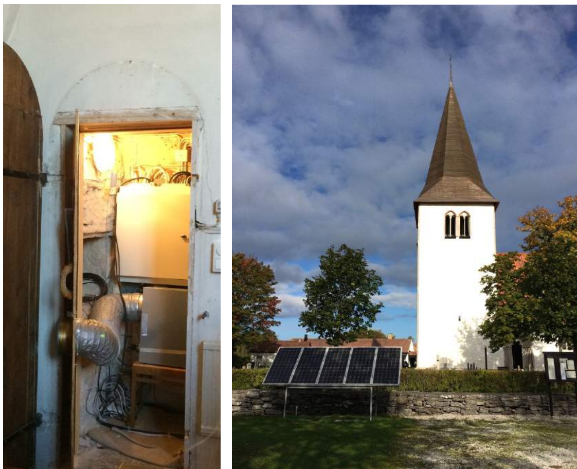
Figure 5.8, 5.9. Chiesa di Hangvar sull'isola di Gotland, in Svezia. Il sistema di ventilazione per il controllo dell'umidità degli ambienti interni è collocato nel vano scala che dà accesso allo spazio sotto tetto. All'esterno del giardino della chiesa, alcuni moduli fotovoltaici provvedono alla produzione dell'energia necessaria per il preriscaldamento dell'aria.
