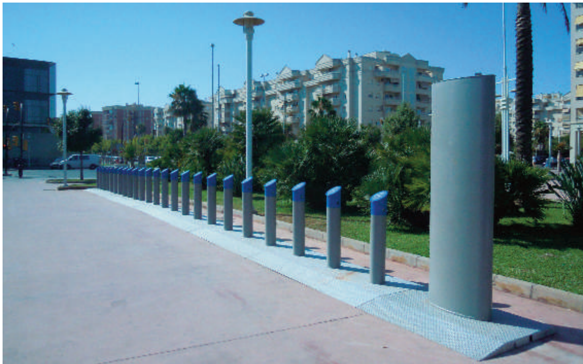
Fig. 43 – Le colonnine di ricarica per i veicoli elettrici nella Playa de la Misericordia .
