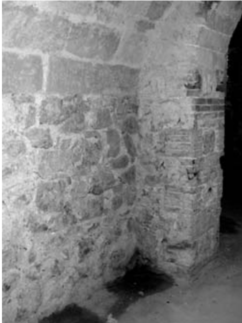
Fig. 8.4 - Per evitare la risalita capillare, le fondazioni ed i muri controterra erano realizzati con materiale lapideo compatto. L'immagine mostra il piano cantinato di un edificio palermitano di fine Ottocento, in cui i conci di calcarenite erano posti in opera sopra un apparecchio murario costituito dal più compatto calcare di Boccadifalco.
