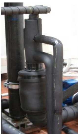
Figura 4.11 Sottoraffreddatore e serbatoio.
