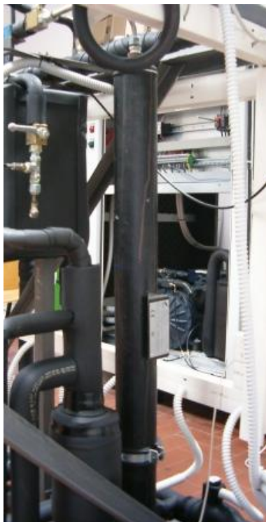
Figura 4.21 Vaso di espansione.
