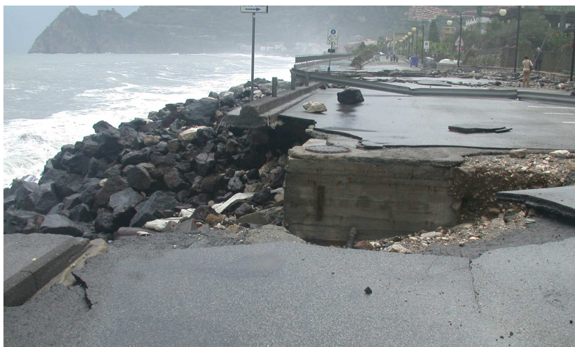
Figura 3.1 - Infrastruttura viaria danneggiata nel 2003 durante una mareggiata. Lungo mare di Sant'Alessio Siculo in provincia di Messina (litorale ionico).
