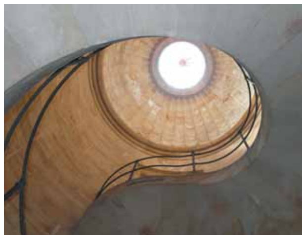
1. Palermo. Palazzo dei Ministeri, la scala vista dal basso (foto M. R. Nobile).
