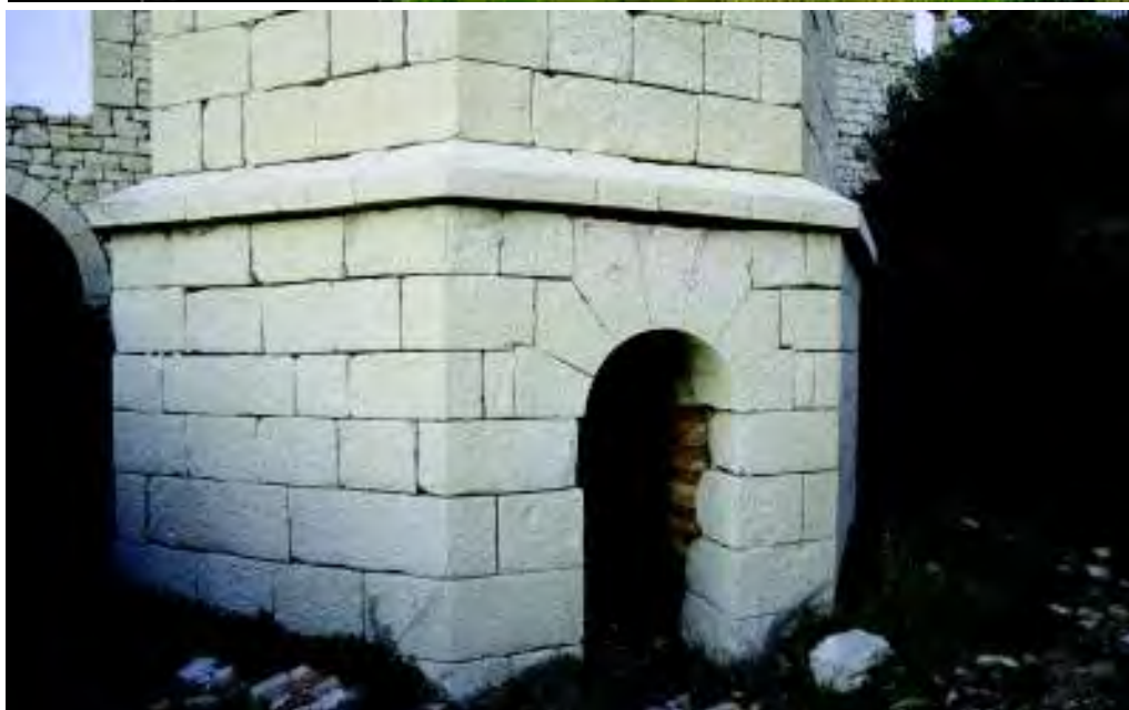
L'alto basamento della ciminiera, rivestito esternamente in pietra calcarea e impreziosito da semplici accorgimenti stilistici, conferisce maggiore solennità all'intero complesso. (Foto C. Bustinto).
