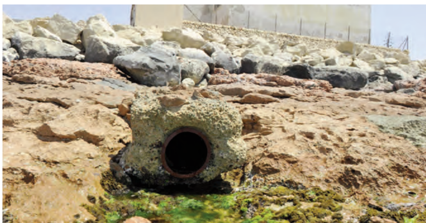
Uno dei tanti sbocchi di canali di scolo abusivi per reflui lungo la costa.
