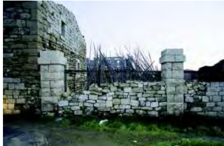
L'ingresso all'opificio, oggi ostruito dalla presenza di blocchi lapidei posti a ridosso di quello che resta della struttura metallica di una recinzione in tubi dalmine. (Foto C. Bustinto).
