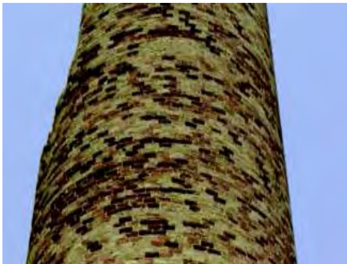
Dettaglio del paramento murario del camino in cui si evidenzia il distacco dei mattoni provocato dal degrado della malta. (Foto C. Bustinto).
