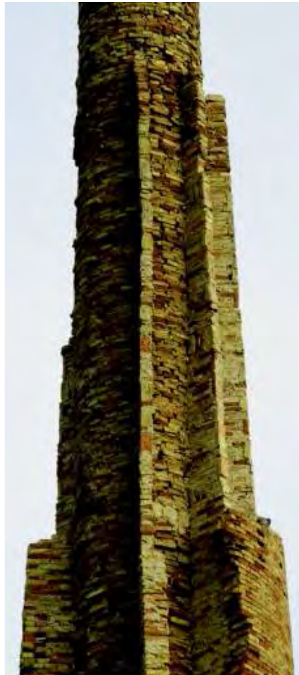
Dettaglio della tecnica costruttiva impiegata per la costruzione del camino. (Foto C. Bustinto).
