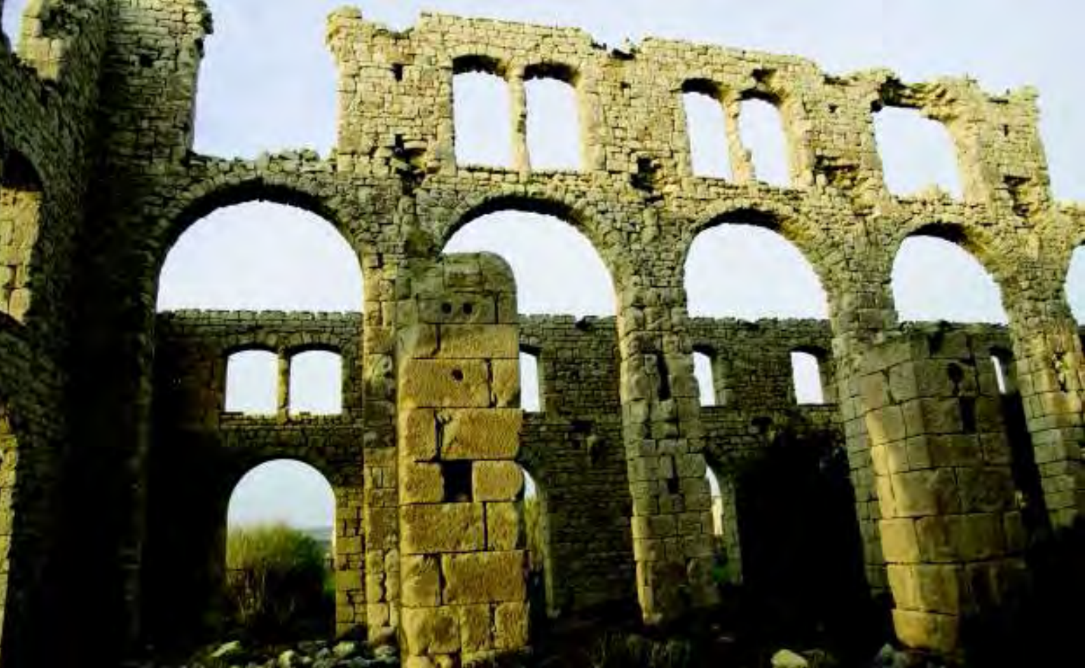
Le grandi arcate delle navate centrali fortemente danneggiate. (Foto C. Bustinto).
