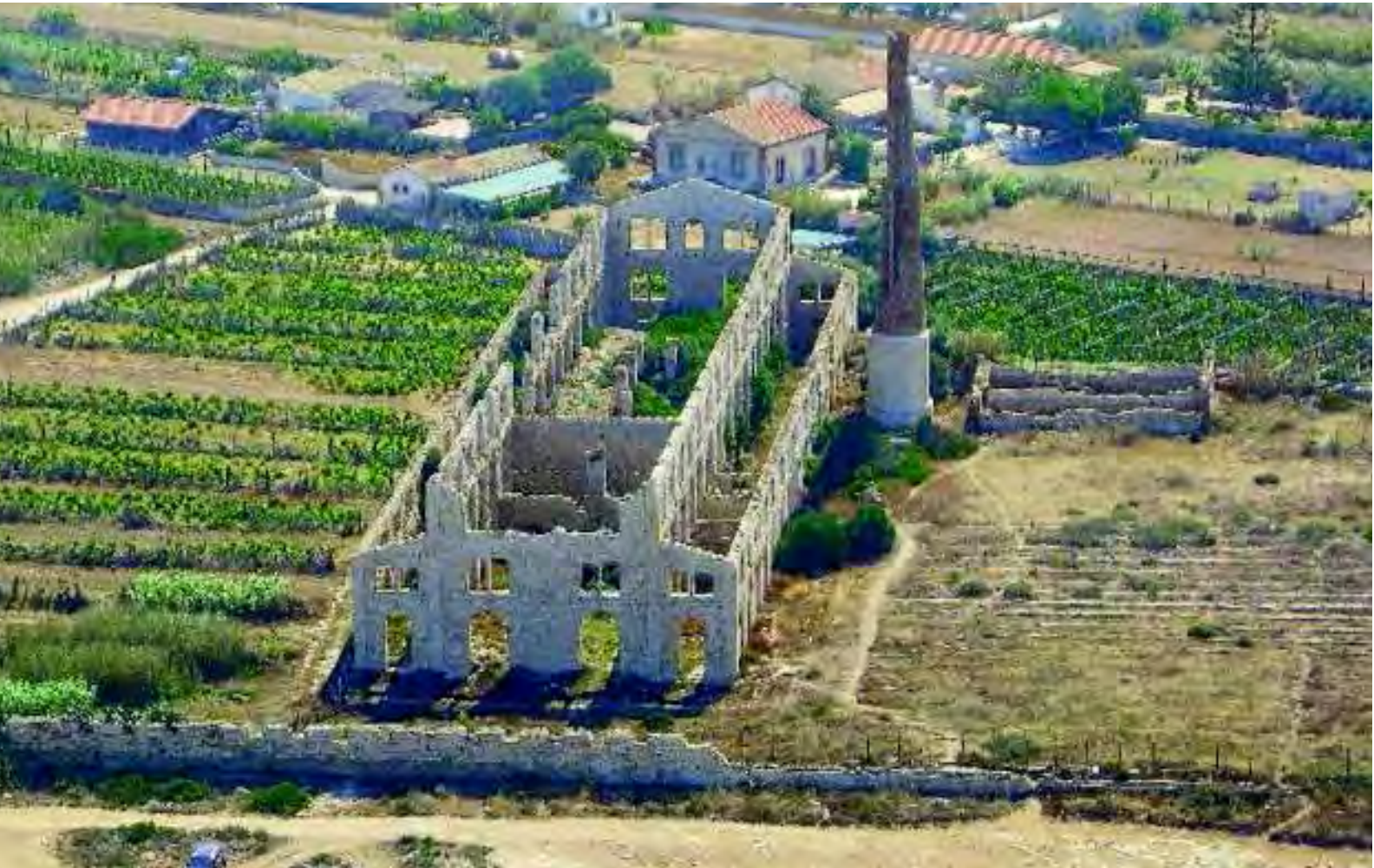
Suggestiva immagine della fornace ripresa dall'alto in cui è possibile valutare le condizioni di degrado in cui versa il manufatto. (Foto tratta dal sito http://www.vanityfair.it . Viaggi di Archeologia Industriale in Italia).
