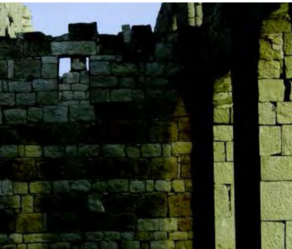
Dettaglio di alcuni conci costituenti una porzione del paramento di un setto murario interno. (Foto C. Bustinto).
