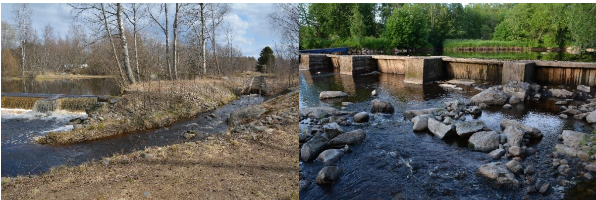
Kuva 4. Peruskosken padon uusi kalatie (eteläranta) keväällä noin 9 \text{ m}^3/\text{s} virtaamalla (vasen kuva) ja Peruskosken pato kesällä alhaisella 2 \text{ m}^3/\text{s} virtaamalla (oikea kuva). Alhaisella virtaamalla padon yli ei tule vettä, vaan vesi ohjautuu pääasiassa Peruskosken voimalaitoksen yläkanavaan (ks. Kuva 22). Kuvat: Panu Orell.
