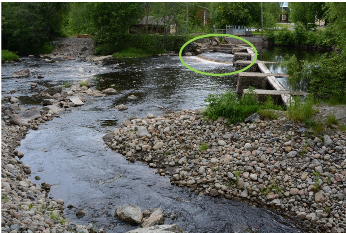
Kuva 2. Peruskosken padon pohjoispäähän 1980-luvulla rakennettu vanha kalatie (vihreä soikio) kuvattuna vajaan 5 m 3 /s virtaamalla. Kuva: Panu Orell.
