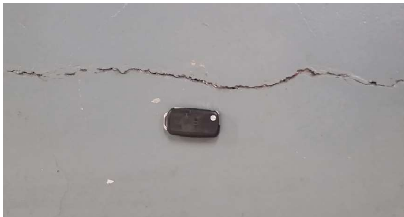
Fig. 4 – Fissura na face superior da laje analisada
