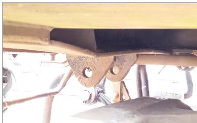
Fig. 5 – Visualização da zona do cabeçote de um chassis, com deformação localizada.
