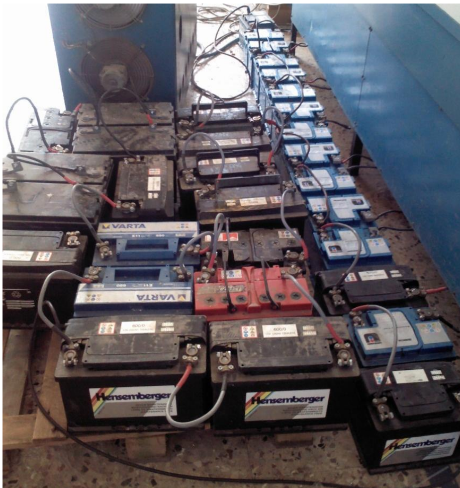
Fig. 4.13 – Batterie al PB usate per i test.
