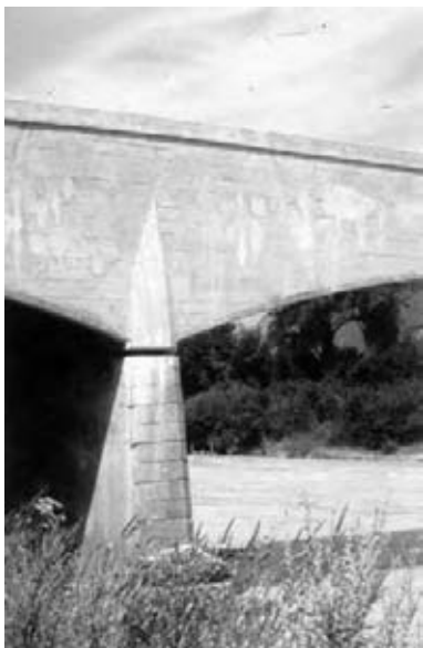
Fig. 20. SARRASIN A., Ponte di Dorénaz , vista ravvicinata, che documenta l'entità dei "rappezzi" (foto di E. Brihwiler)
