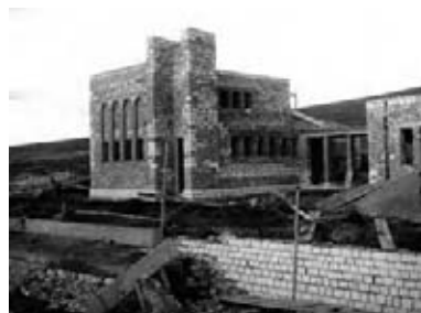
Fig. 1. Borgo Manganaro, Lercara (Palermo), la chiesa, in costruzione, da Ente per la Riforma Agraria in Sicilia, album fotografico
