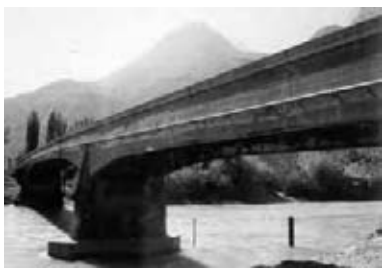
Fig. 19. SARRASIN A., Ponte di Dorénaz, Vallese 1933 , prima dell'intervento di ripristino del 1999, condotto dall'ingegnere Sugan Brihwiler. In origine, questo ponte di appena 5 metri di carreggiata, era limitato a convogli di meno di 16 tonnellate. Col tempo la carbonatazione aveva messo a nudo qualche sbarra d'armatura delle travi principali, ma il vero problema consisteva nella richiesta di portare il carico massimo a 40 tonnellate. L'ingegnere, ricorrendo alle conoscenze recenti sul comportamento delle strutture in calcestruzzo armato, ha potuto soddisfare questa esigenza senza "colpo ferire", limitando il restauro a dei circoscritti interventi di rappezzo, che conservano pressoché intatti il colore e la patina del calcestruzzo d'origine. (foto di E. Brihwiler)
