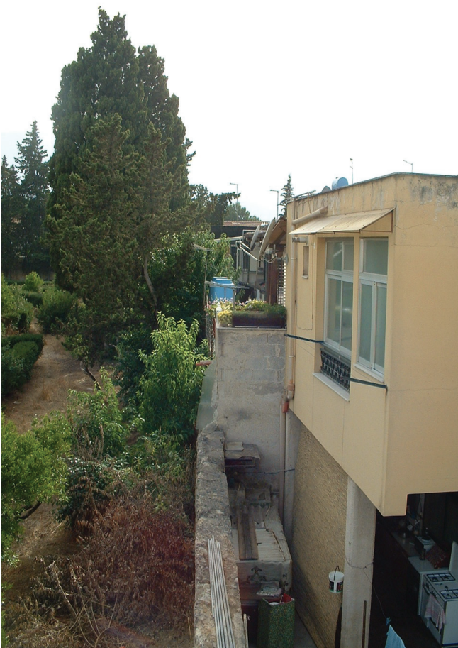
Foto 13 - Il disastro edilizio a ridosso del muro di contenimento rappresentato -paradossalmente- dal belvedere in direzione dell'edera centrale. A parte l'aggressione fisica che potrebbe comunque parzialmente risolversi con una fitta schermatura di Cupressus sempervirens , resta comunque di ardua soluzione il problema relativo al silenzio del giardino.
