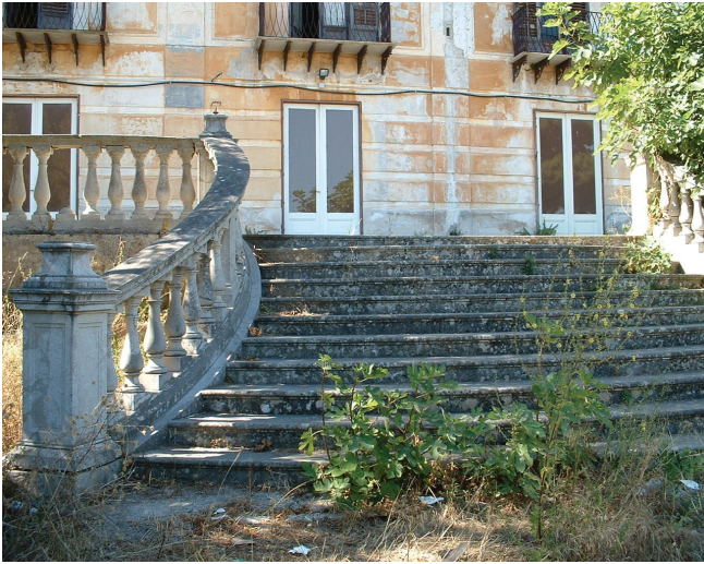
Foto11 - La scalea che collega la terrazza al giardino, si presenta in buono stato, malgrado sia intaccata alla base, da un piccolo esemplare di Ficus carica L.
