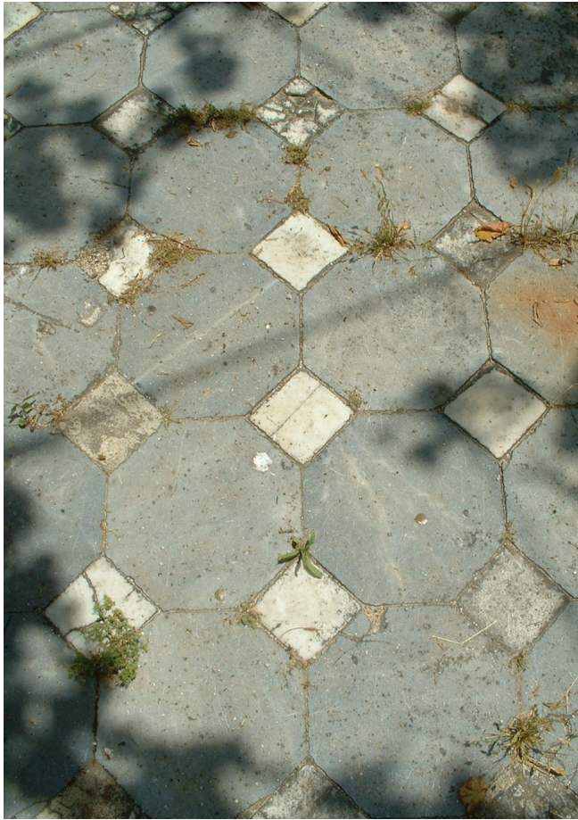
Foto 7 - Dettaglio della pavimentazione della terrazza in elevato stato di degrado materico dovuto sia alle condizioni di naturale decadimento del marmo, sia all'azione di agenti biodeteriogeni quali, radici tra le fughe delle piastrelle, condizioni climatiche avverse, ecc.
