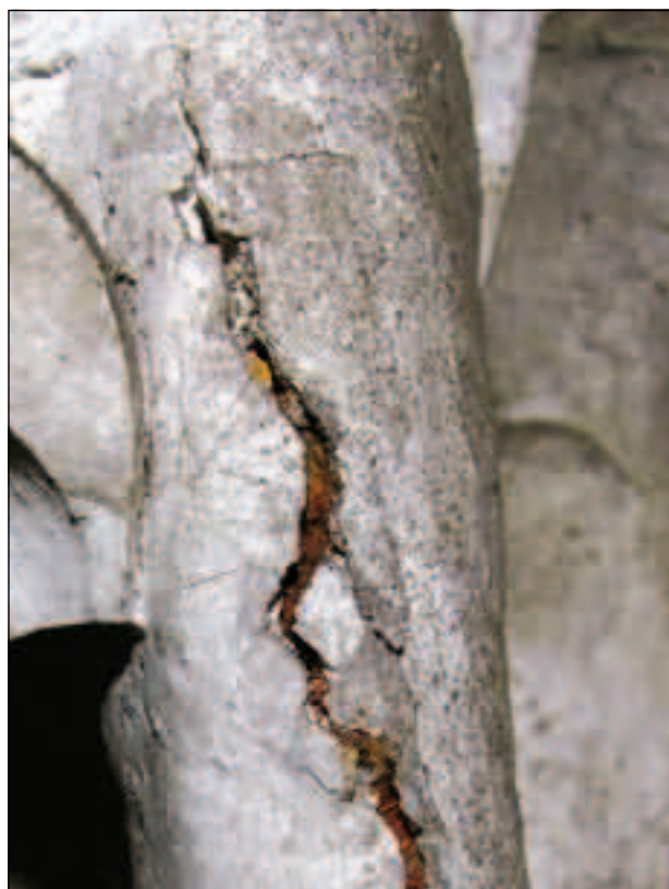
Fig. 35 – Giacomo Serpotta, Cappella delle Anime Purganti , 1695-1696, chiesa di Sant'Orsola, Palermo, particolare del teatrino presente sulla parete di destra. La corrosione degli elementi metallici causata dall'umidità ha provocato evidenti lesioni sulla superficie degli stucchi.
