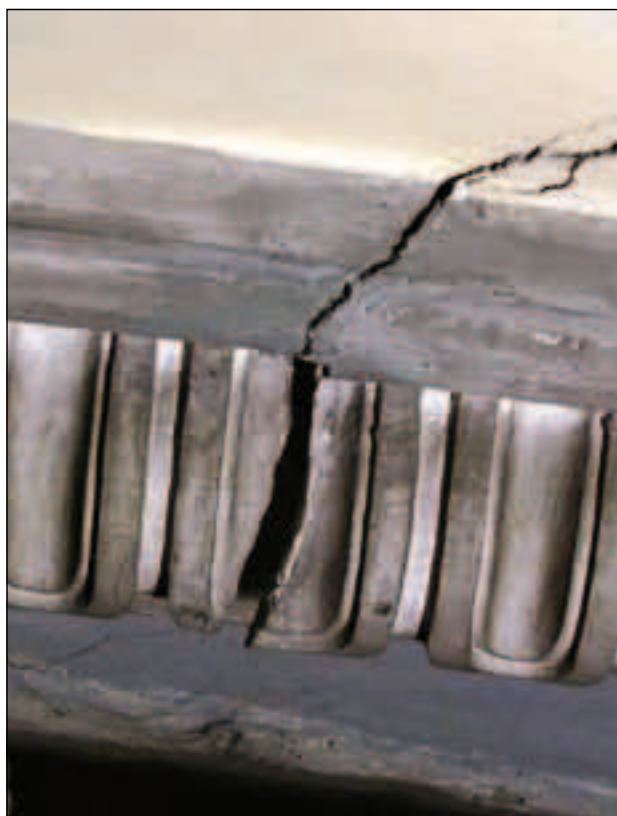
Fig. 34 – Giacomo Serpotta, Cappella delle Anime Purganti , 1695-1696, chiesa di Sant'Orsola, Palermo, particolare che mostra la profonda lesione della struttura muraria che coinvolgeva anche parte della decorazione in stucco.
