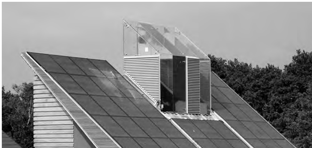
Il particolare del camino del vento, posizionato sulla facciata Nord di Kingspan Lighthouse.
