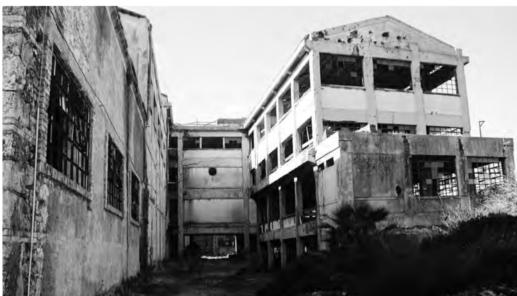
Un pronunciato degrado segna gli Edifici 6 e 7.
