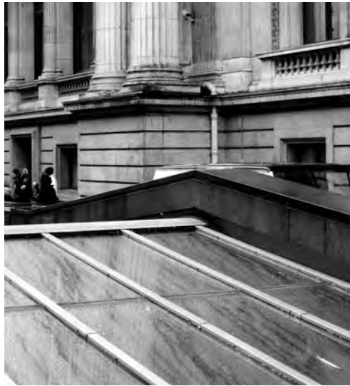
La condensa e i riflessi rendono poco efficace la copertura realizzata sul sito di Bruxella 1238 a Bruxelles (Belgio).
