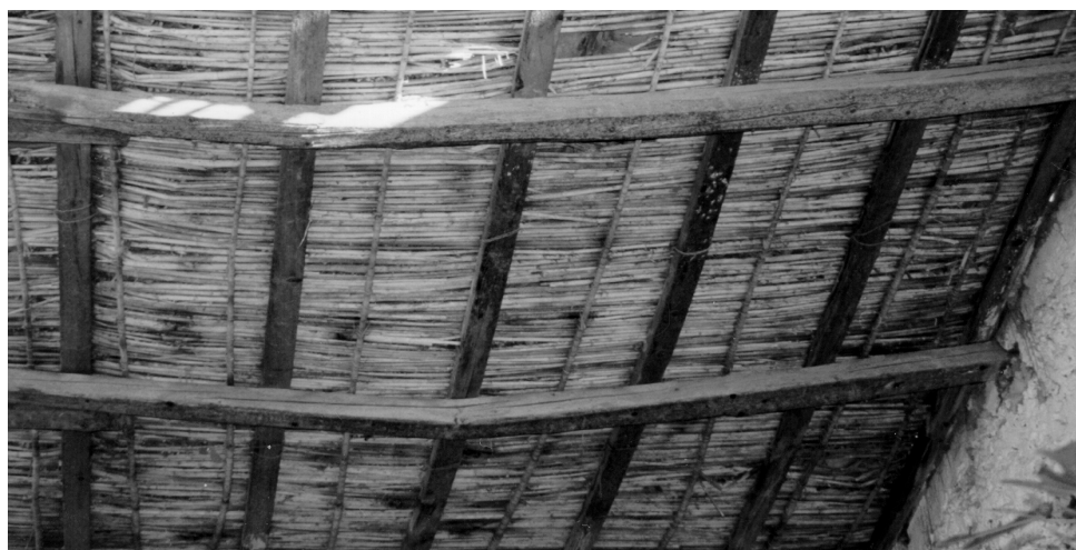
Figura 4 - Stalla del Baglio Baiata. Cedimento dell'arcareccio
