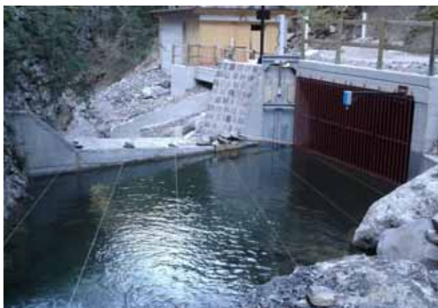
Figura 3.8 – Presa di derivazione per la centralina idroelettrica sul Ru Davedin.
